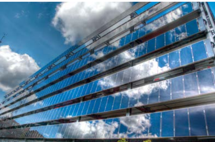
Abb. 11: Photovoltaik an der Parkhausfassade (Quelle: Robert Müller)
